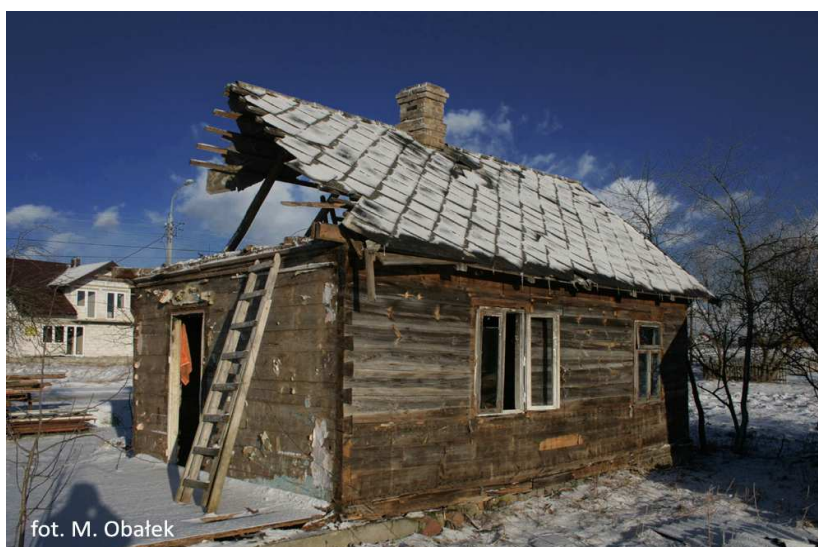
Fot.1. Przykładowe zagrożenie spowodowane niszczeniem pokryć dachowych, z których uwalniają się włókna azbestowe.
